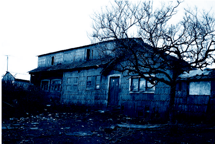
Fotografía 13: vivienda de tejas deteriorada
